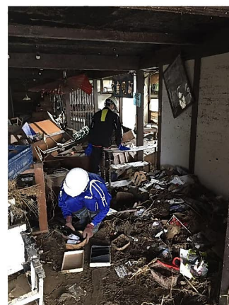
令和2年7月豪雨 被災時の様子 （鳥越商店の店舗内）
