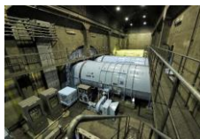
関越トンネル 谷川地下換気所
